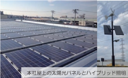
本社屋上の太陽光パネルとハイブリッド照明
