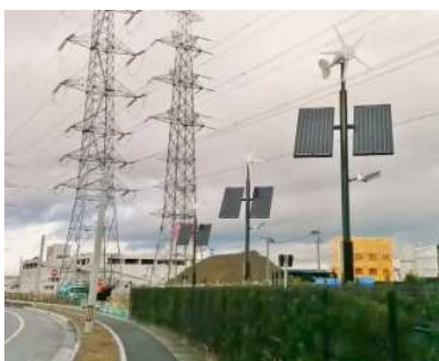
EM21設置 ハイブリッド照明 (2014年 10月設置)
