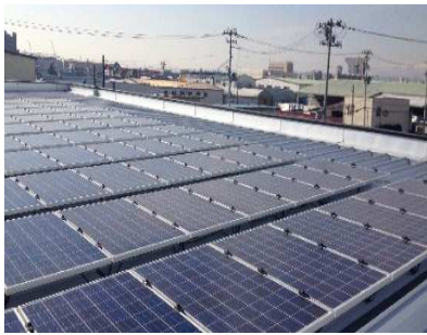
本社 屋上設置の太陽光パネル
