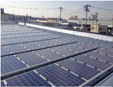
本社 屋上設置の太陽光パネル
