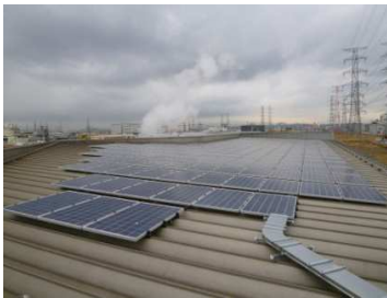
EM21 屋上設置の太陽光パネル
