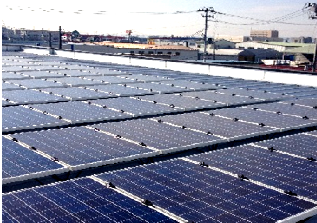
屋上設置の太陽光パネル
